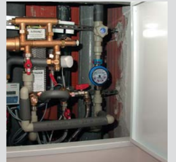
Uygulamada konut sıcak su istasyonu
